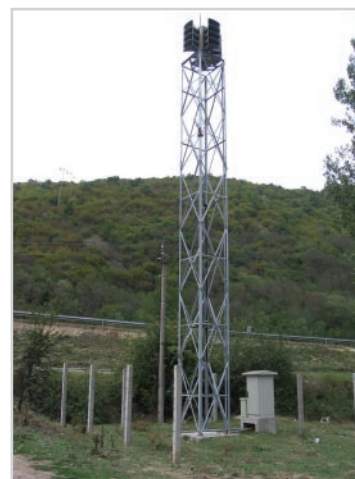
Alarmna stanica na objektu
