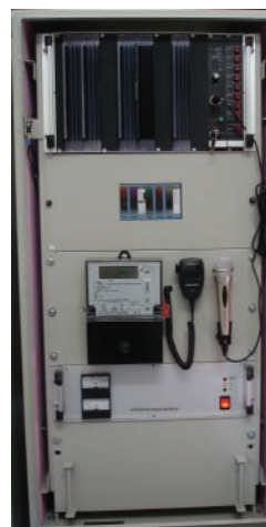
Alarmna stanica – unutrašnji raspored opreme
